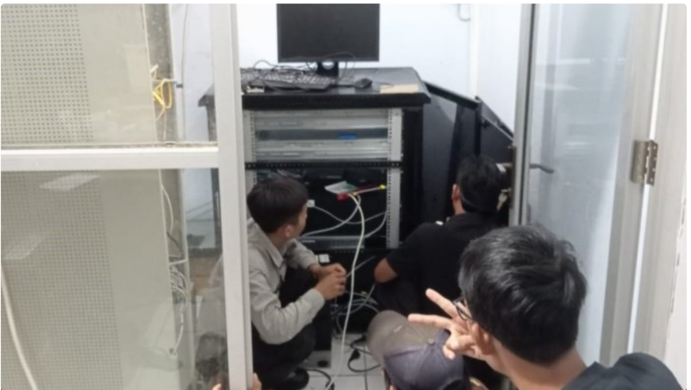
Tingkatkan Pengamanan, Lapas Besi Lakukan Perawatan Server CCTV
